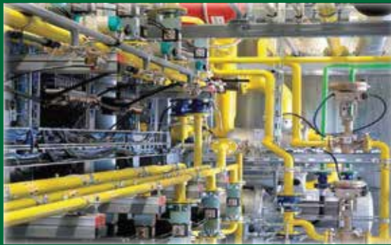
Vista interior planta de Enriquecimiento de Biogás
