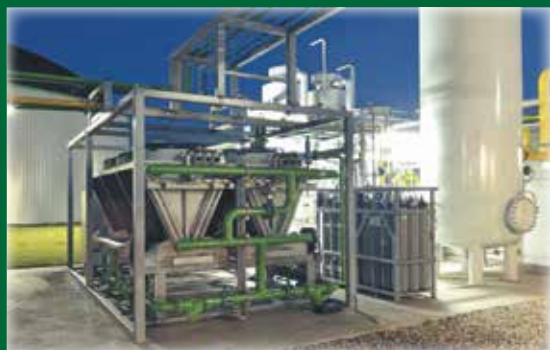
Planta de Enriquecimiento de Biogás
