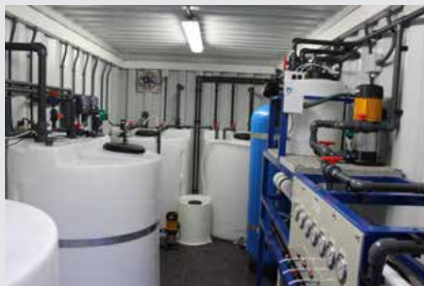
Interior del contenidor d'Osmosi Inversa
