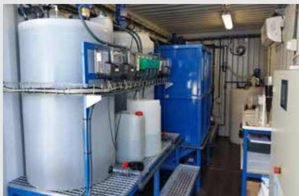
Interior del contenidor Físic - Químic
