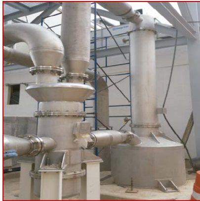
Intercambiador de calor
